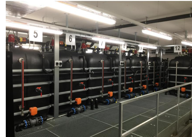
Exemple d'installation de contrôle des eaux usées. Photo: P. Koch
